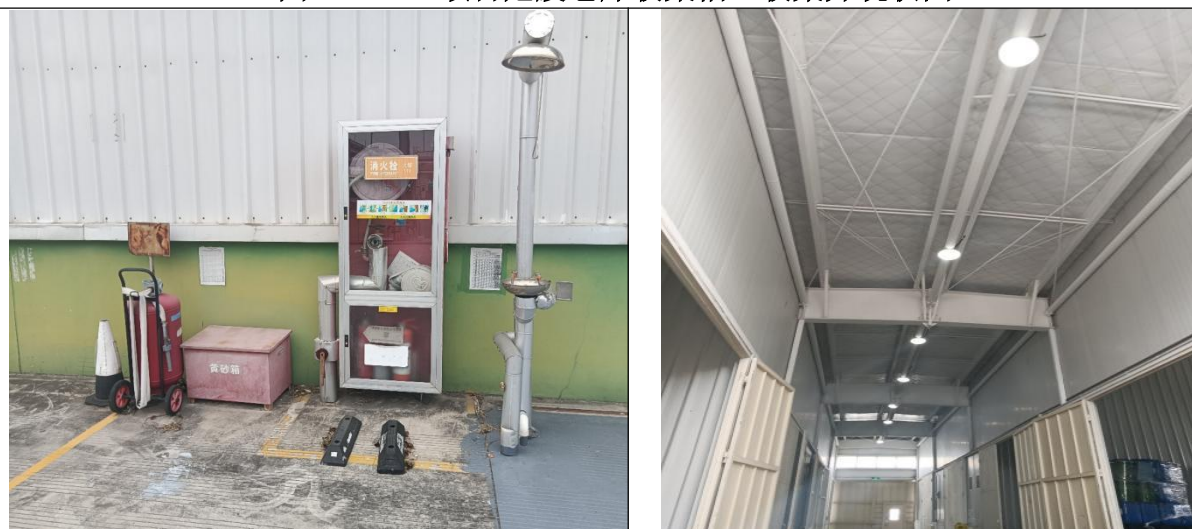
图 6.4.2-7 项目危废仓库消防设施和照明设施照片
